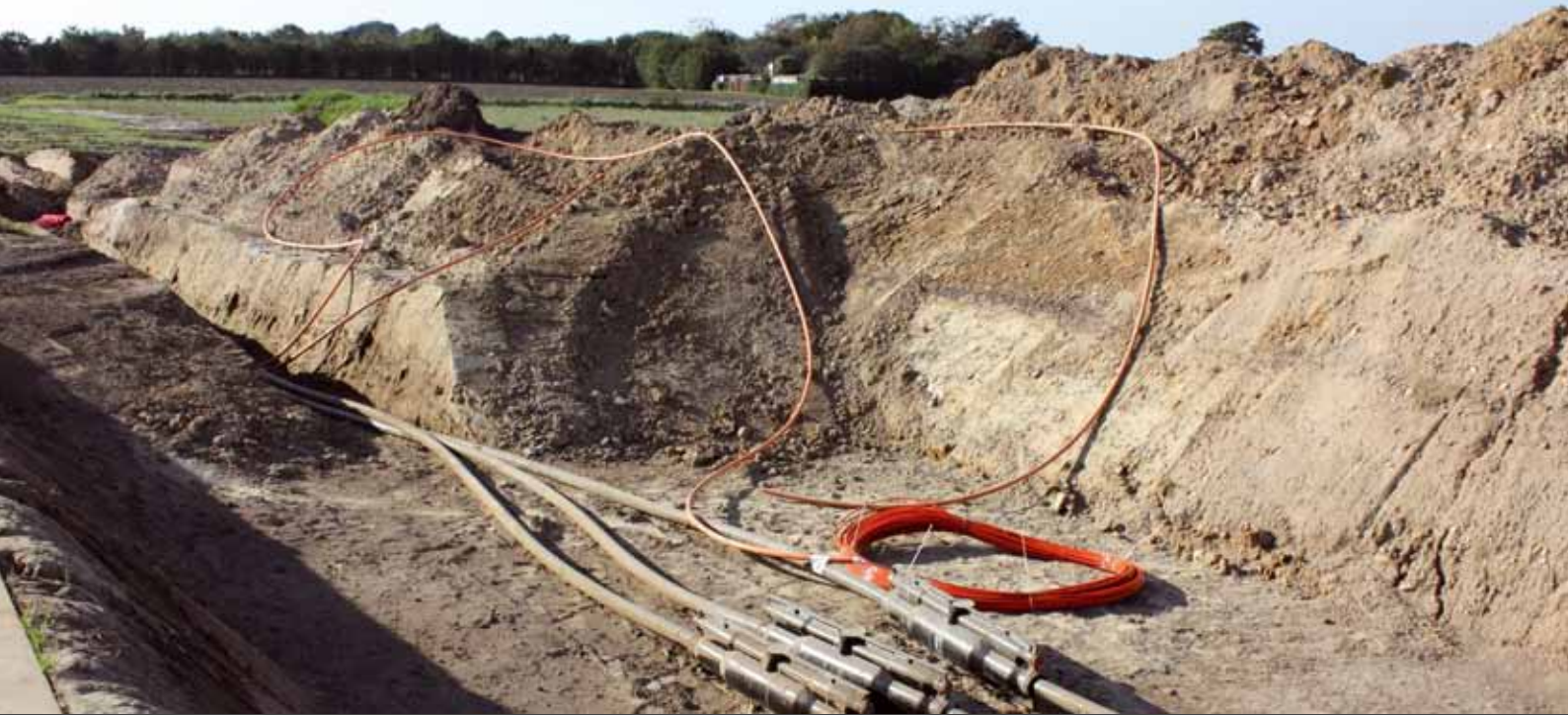
FOTO FRA EN EKSISTERENDE KABELGRAV
