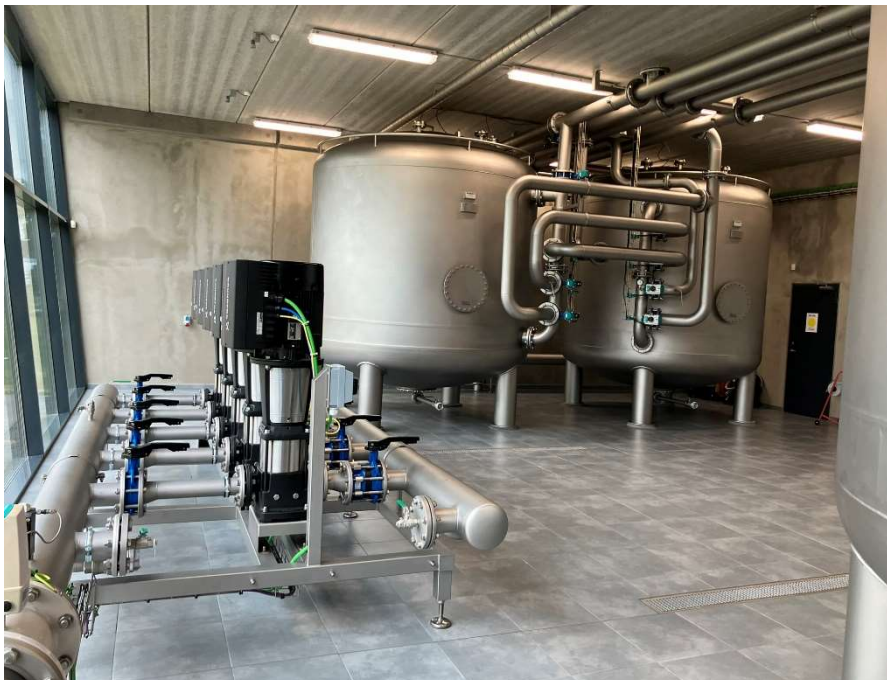
Behandlingsanlæg og udpumpning - Kolt Skovvej
