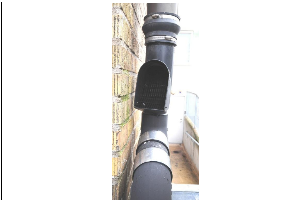
Figur 3.1 Grovfilter på tagnedløb. (Foto: Kaj Vestergaard)
