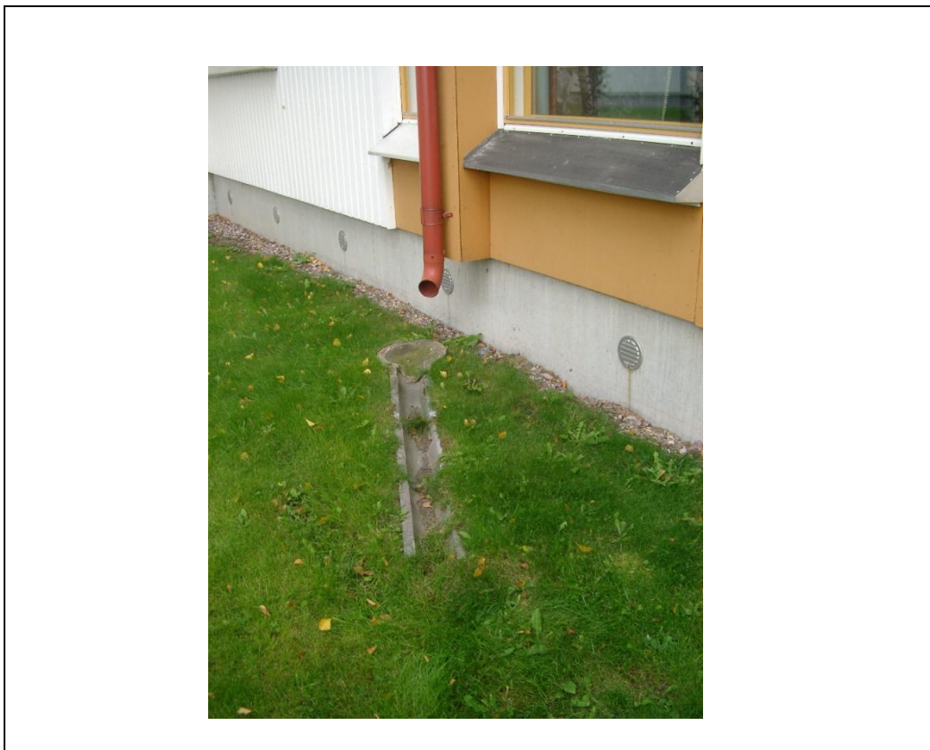
Figur 3.2 Eksempel på strømning af vand fra nedløbsrør til græsplæne.
