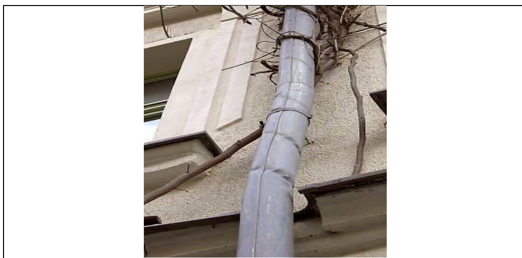
Figur 2.2 Nedløbsrør deformeret af blåregn ( Wisteria ).
