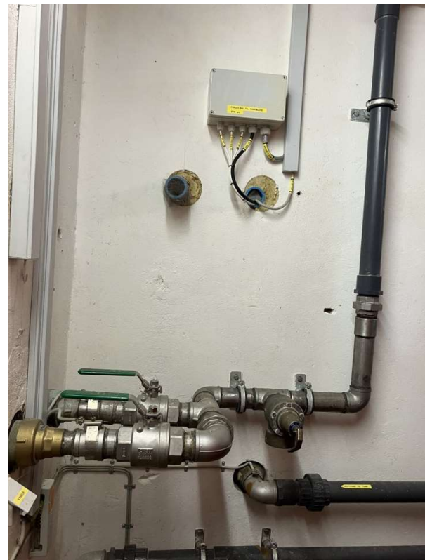
Overløb fra rentvandstanken til vandværksbygning
