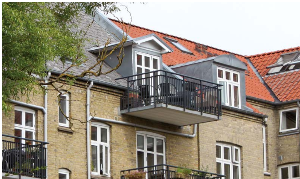
Foto: Altaner i tagetagen som led underliggende kolonne. Gesims brudt ved dørparti.
