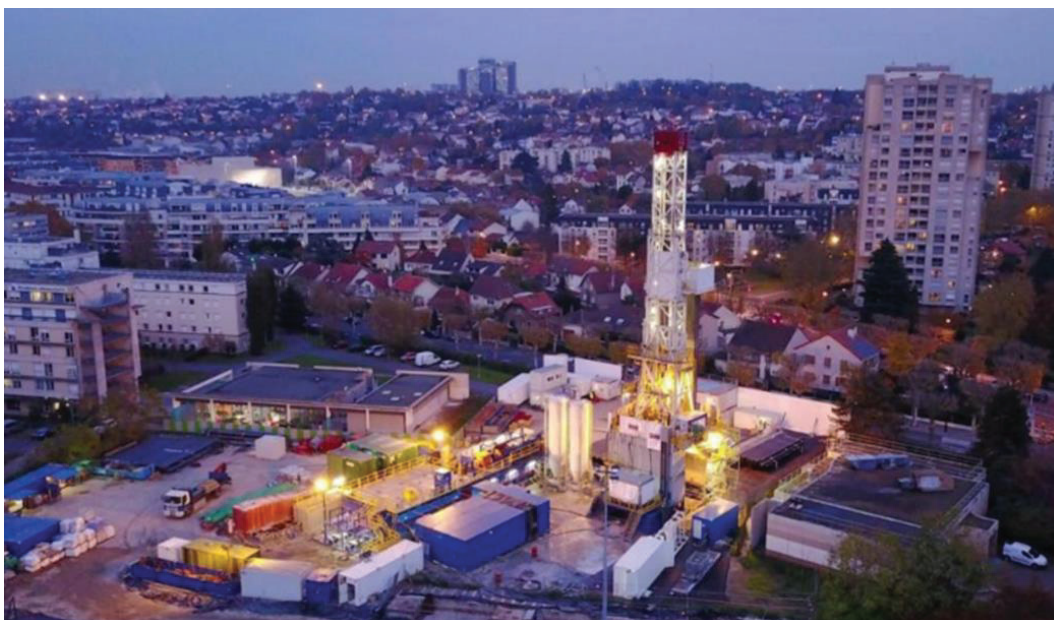
Foto 4 Geotermisk boring i Cachan i Frankrig 2017. Byen har udnyttet geotermisk energi siden midten af 80'erne. Det nye brøndpar skal erstatte to gamle brøndpar og levere varmt vand og varme til hvad der svarer til 7.000 husholdninger (offentlige bygninger, erhverv og lejligheder) (Le Parisien, 2017).
