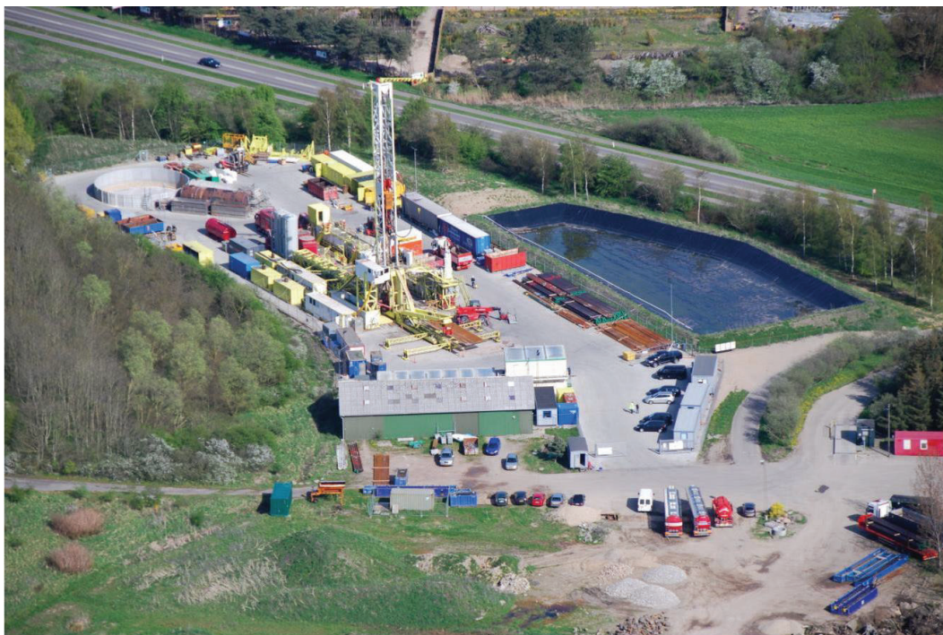
Foto 1 En boreplads med borerig og testbassin i baggrunden (boring ved Sønderborg 2010, det færdige anlæg blev idriftsat i 2013 (Dansk Fjernvarme 2019)
