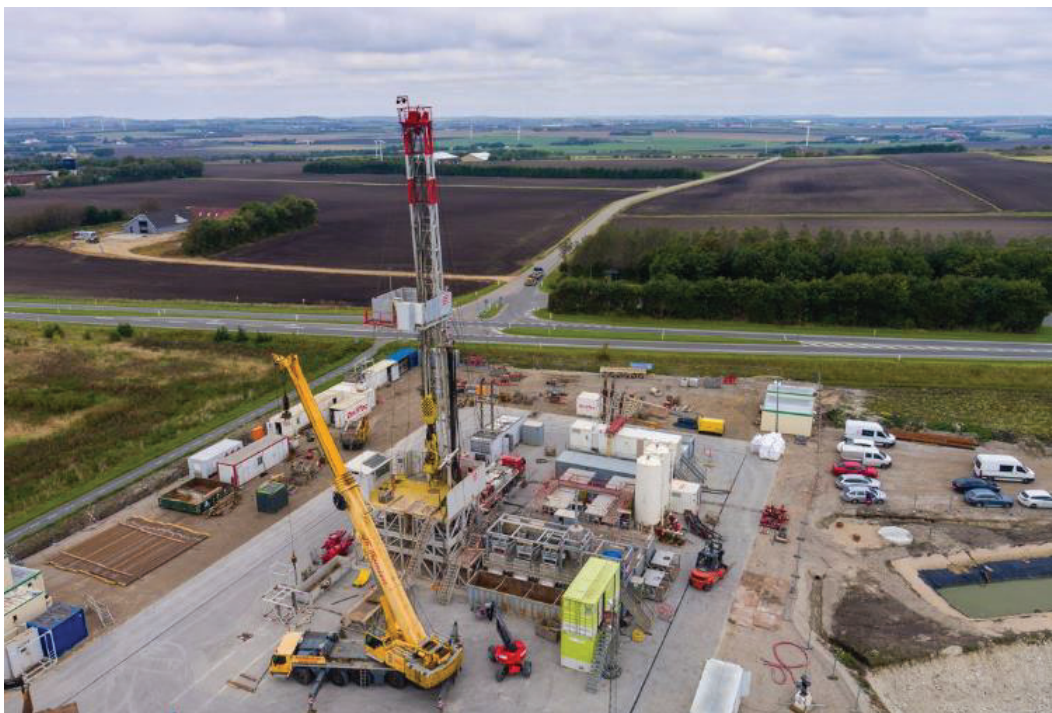
Foto 2 En borerig sættes op (boring af Injektions brønd i Thisted 2017, Thisted Varmeforsyning, 2019). Se også timelapse film på ca. 5 minutters varighed af boringen på https://www.thisted-varmeforsyning.dk/geotermi/
