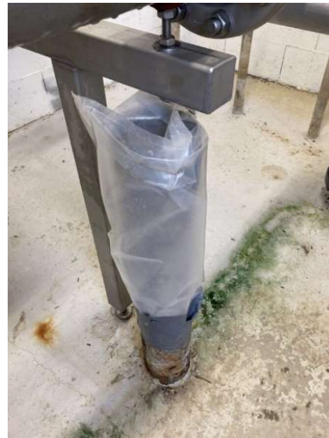
Ukendt rørstump der måske skal sløjfes
