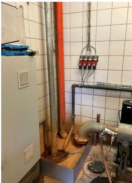
Afledning af filterskyllevand
