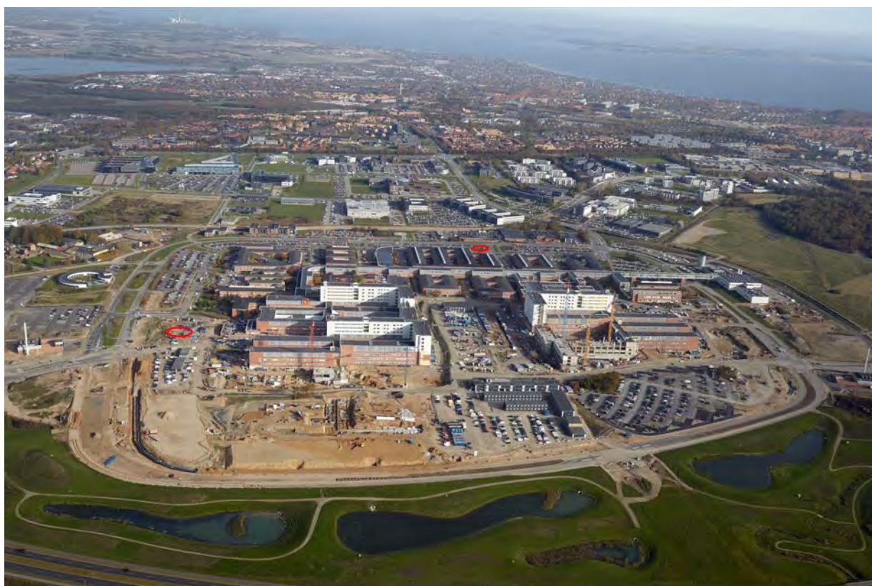
Figur 1-1. Placering af heliport H1 ved akutcentret (rød cirkel til venstre) og heliport H2 ved hjertecentret (rød cirkel midt i foto).
